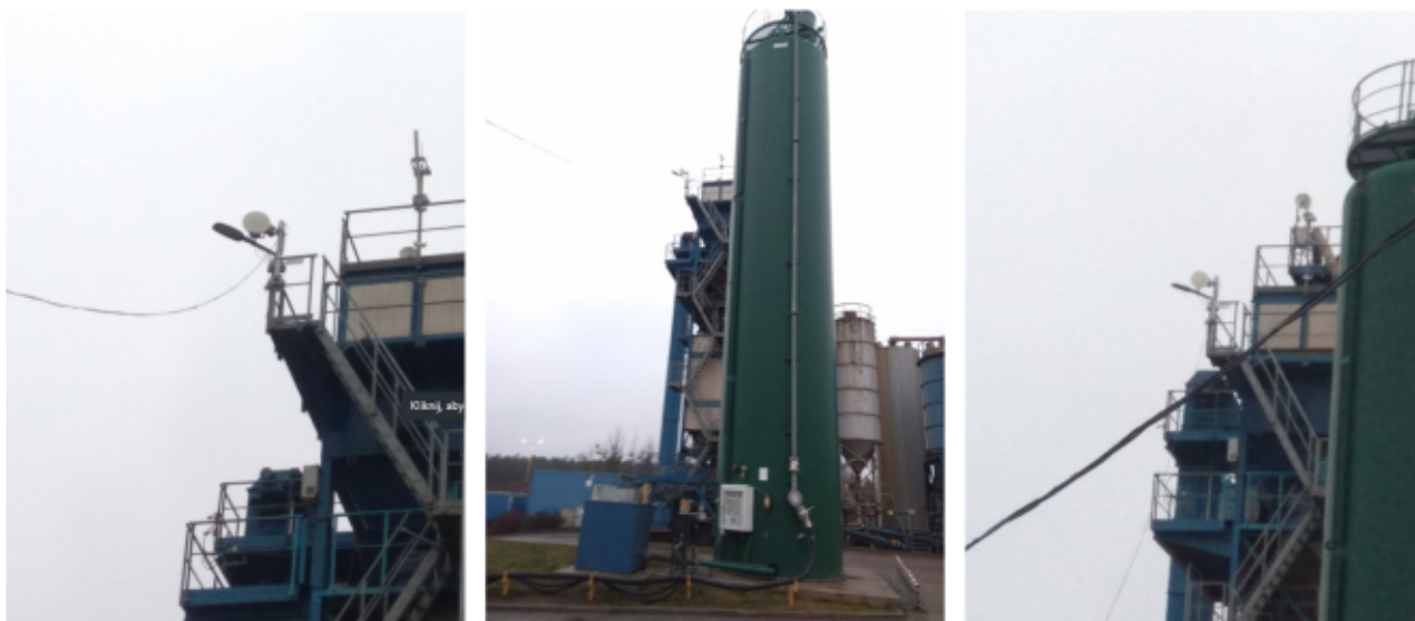
Widok obiektu wraz z zainstalowanym zespołem antenowym
